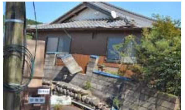
〔陥没で傾いた家〕
